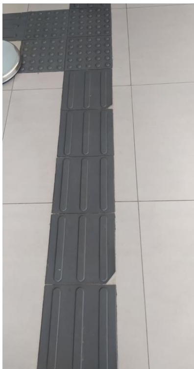
Piso tátil quebrado – Hall de entrada
