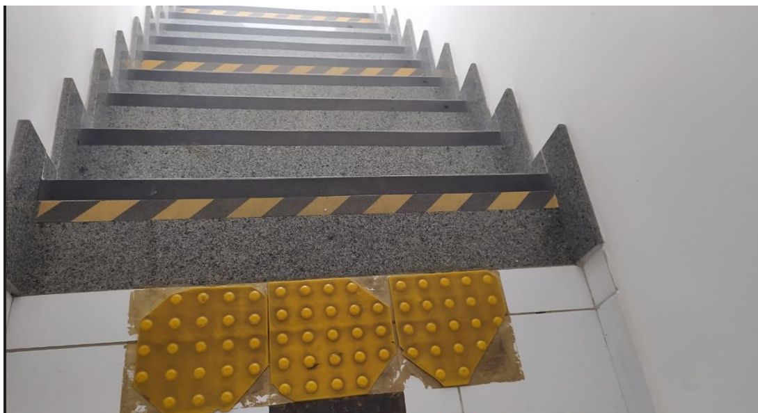
Piso tátil quebrado – Escada (3º andar)
