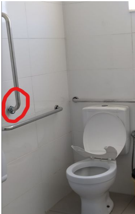
Barra de apoio vertical solta na parte inferior (Banheiro – Prédio novo)
