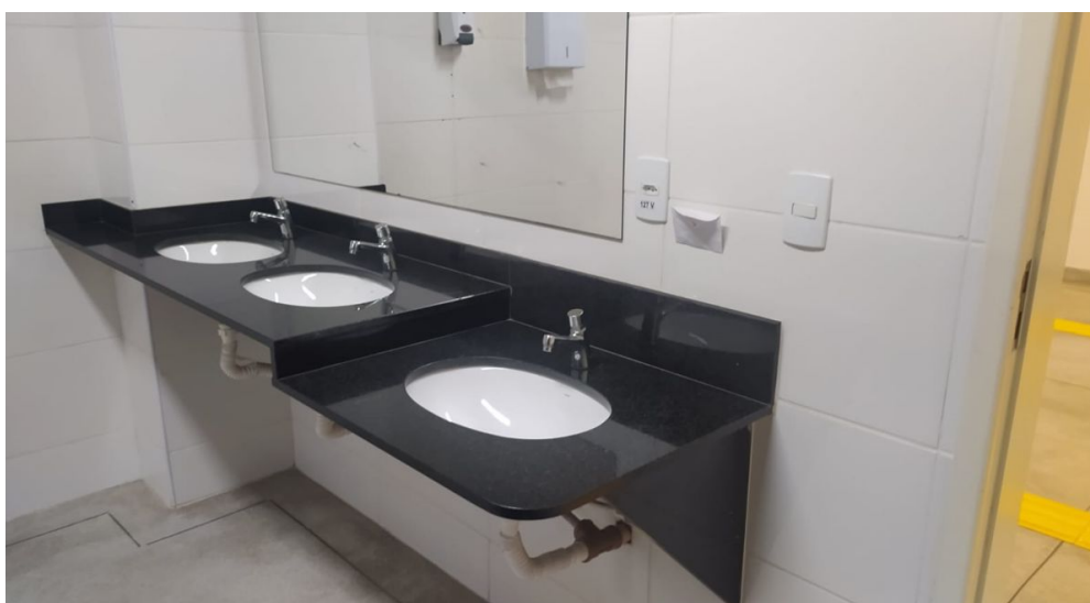
Banheiro sem barra de apoio junto à pia - Bloco G
