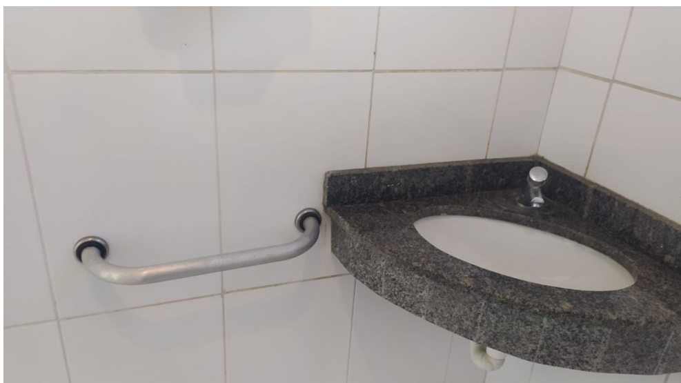
Banheiro com apenas uma barra de apoio junto à pia - Bloco F
