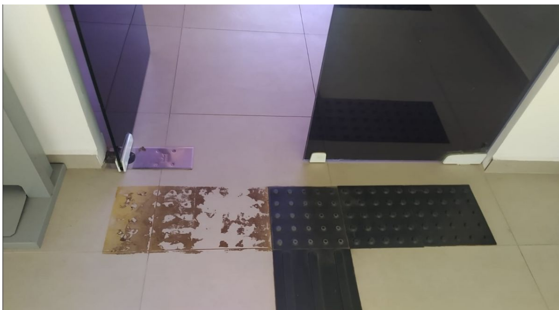
Piso tátil descolado – Porta da cozinha (3º andar)
