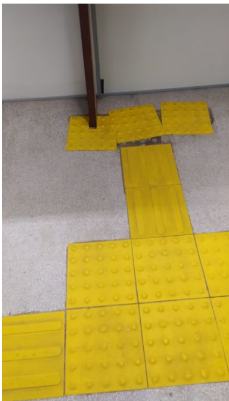
Piso tátil colado de maneira inadequada (prédio antigo)
