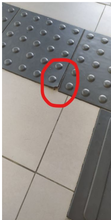
Piso tátil descolado – Hall de entrada
