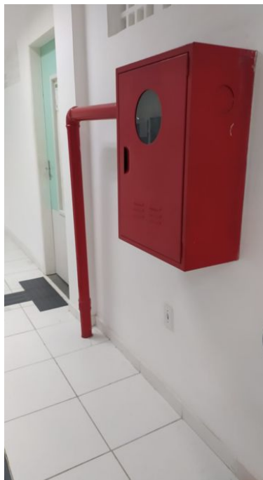
Caixa de incêndio sem sinalização tátil - 2º andar
