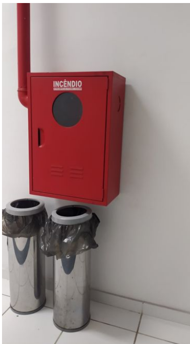
Caixa de Incêndio sem sinalização tátil – 1º andar
